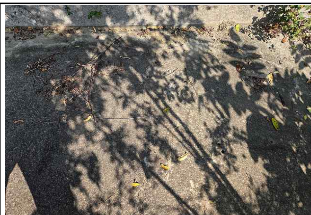
1소단배수로 균열, 토사퇴적
