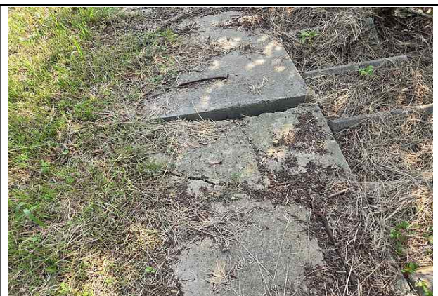
산마루측구 덮개 파손
